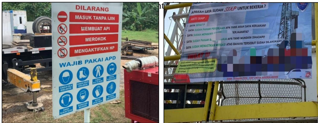
Gambar 5. Poster dan Rambu Keselamatan Kerja Sumber: Dokumentasi Penulis, 2025
